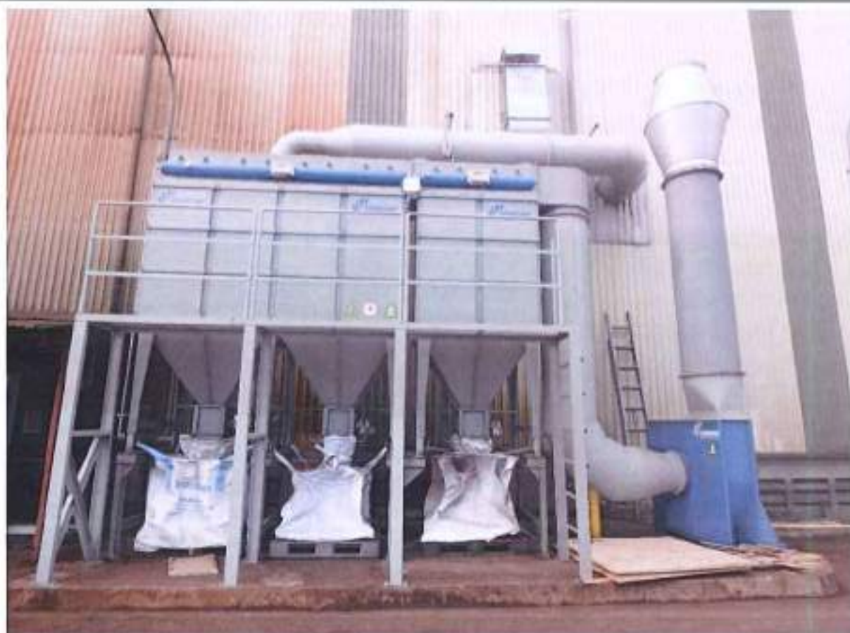
Hình 8: Hệ thống xử lý khí thải lọc túi vải
